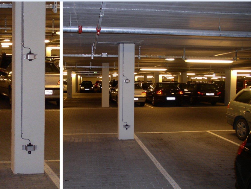
Installation med GP-SB detektorer
